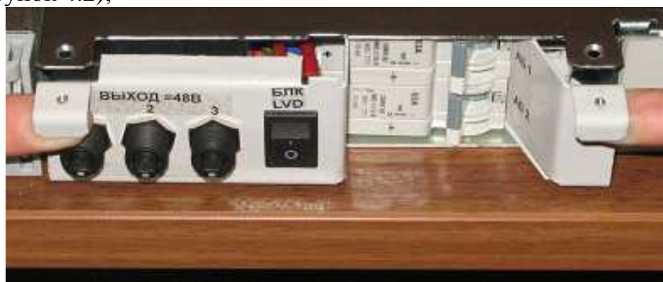
Рисунок 4.2 – Извлечение кронштейна с автоматическими выключателями
